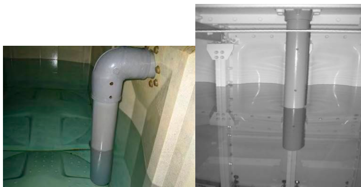
施工禁止の真空破壊孔の例
