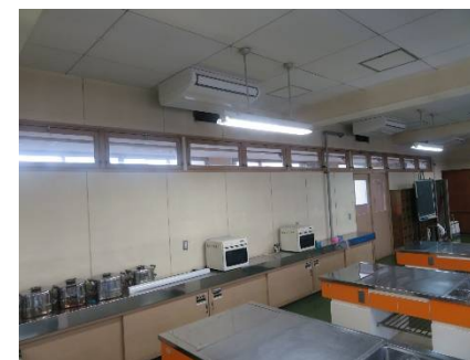
特別教室空調設備整備後（家庭科室）
