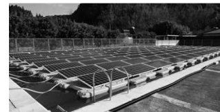
廃プールの水上太陽光発電設備（鹿児島県南さつま市）
