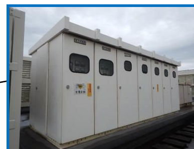
名称：受変電設備 コメント：図体のチョーキング、腐食
