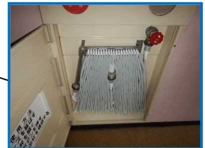
名称：屋内消火栓 コメント：消火栓ホースの更新若しくは性能試験の実施
