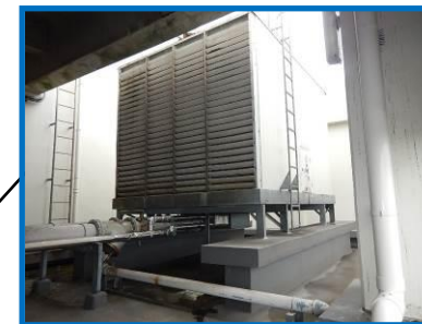
名称：冷却塔 コメント：内部汚れ、スケール堆積
