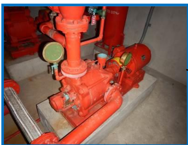
名称：屋内消火栓ポンプ コメント：鉄部の発錆
