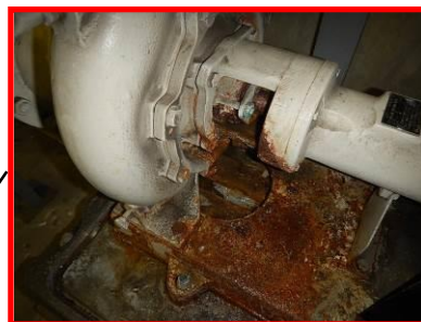
名称：空調冷却水ポンプ コメント：鉄部の発錆
