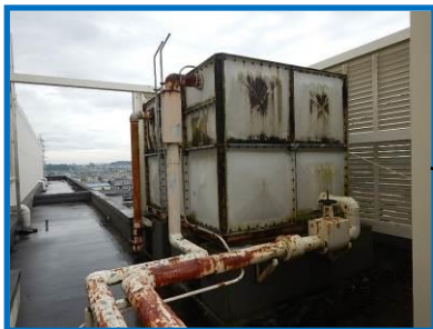
名称：高架水槽 コメント：FRP外板の汚れ、紫外線劣化 鉄部の発錆
