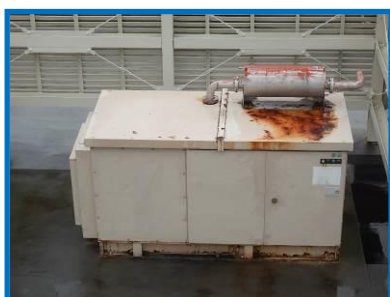
名称：自家発電設備 コメント：図体の腐食
