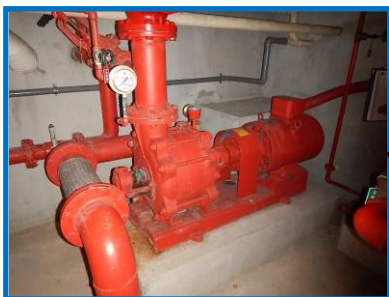
名称：スプリンクラーポンプ コメント：鉄部の発錆
