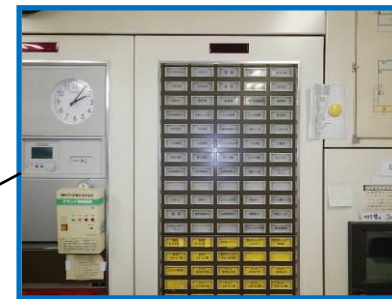
名称：自動火災報知設備 コメント：耐用年数の超過
