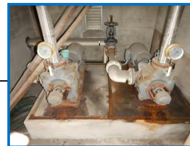
名称：揚水ポンプ コメント：漏水・鉄部の腐食
