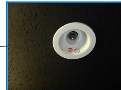
名称：非常用照明器具（各所） コメント：球切れ、バッテリー劣化
