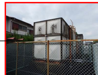
名称：受水槽 コメント：漏水の発生、鉄部の発錆
