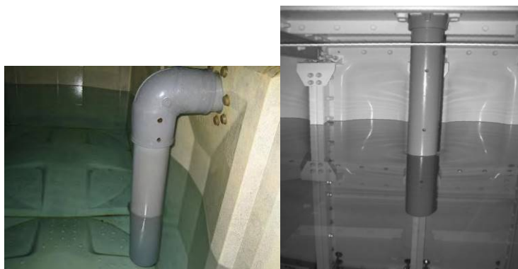
施工禁止の真空破壊孔の例
