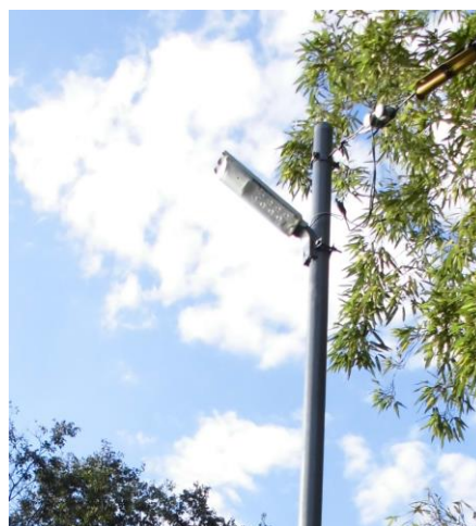
専用柱に設置してある防犯灯 (独立柱の防犯灯)
