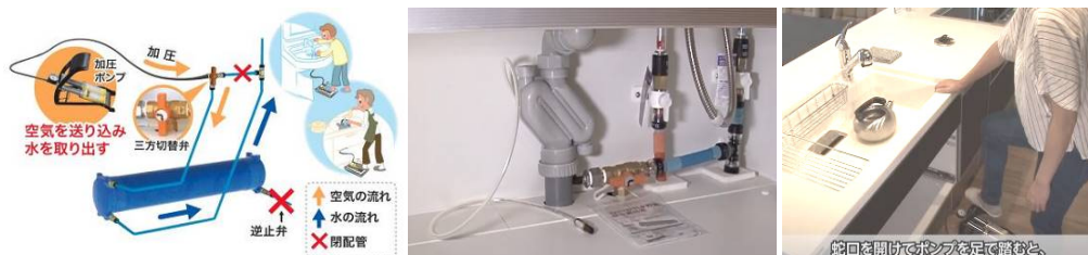
【図 5.6-5】 貯水槽周り配管の一例 流し台下部の操作弁及び足踏みポンプ 〔メーカーHPより〕
