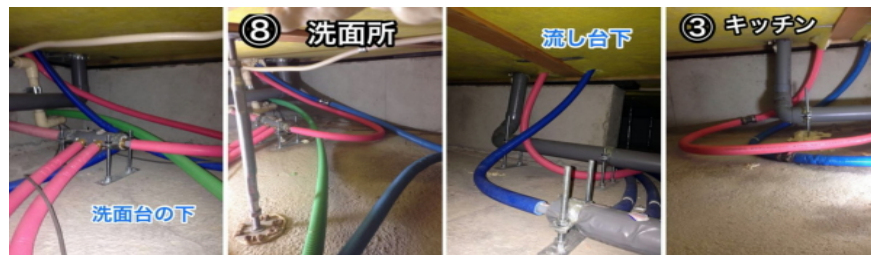
【図 4.8-3】 給水配管の支持箇所不足による施工例
