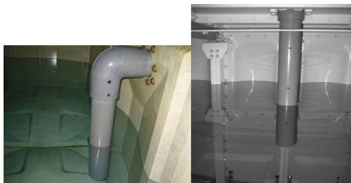
施工禁止の真空破壊孔の例
