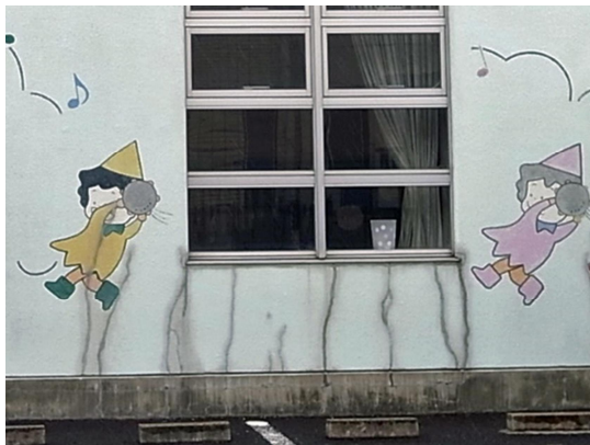
壁面の亀裂（修復済） 本地ヶ原
