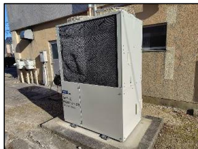
< 更新後の室外機 >
