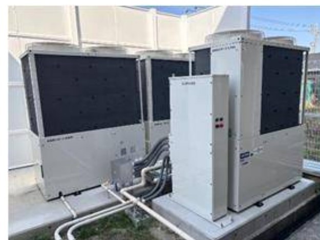
室外機・停電時自立運転ユニット
