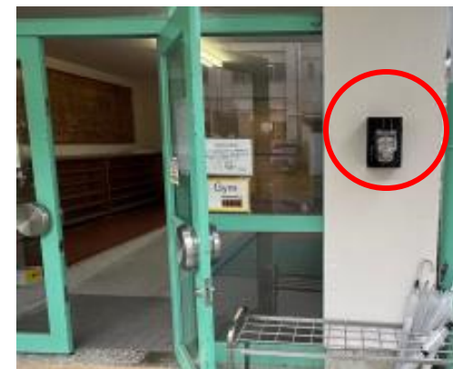
電子錠導入（小学校体育館）
