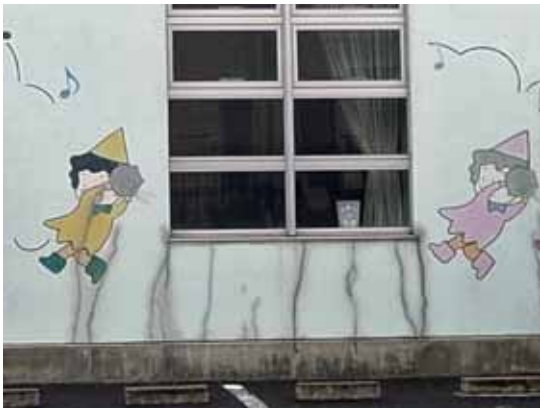
壁面の亀裂(修復済) 本地ヶ原
