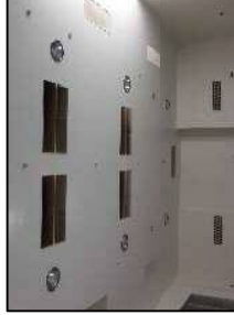
調理場内給排気ダクト
