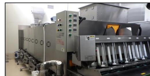
食器類洗浄機システム
